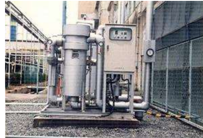
熱水回収過濾裝置
